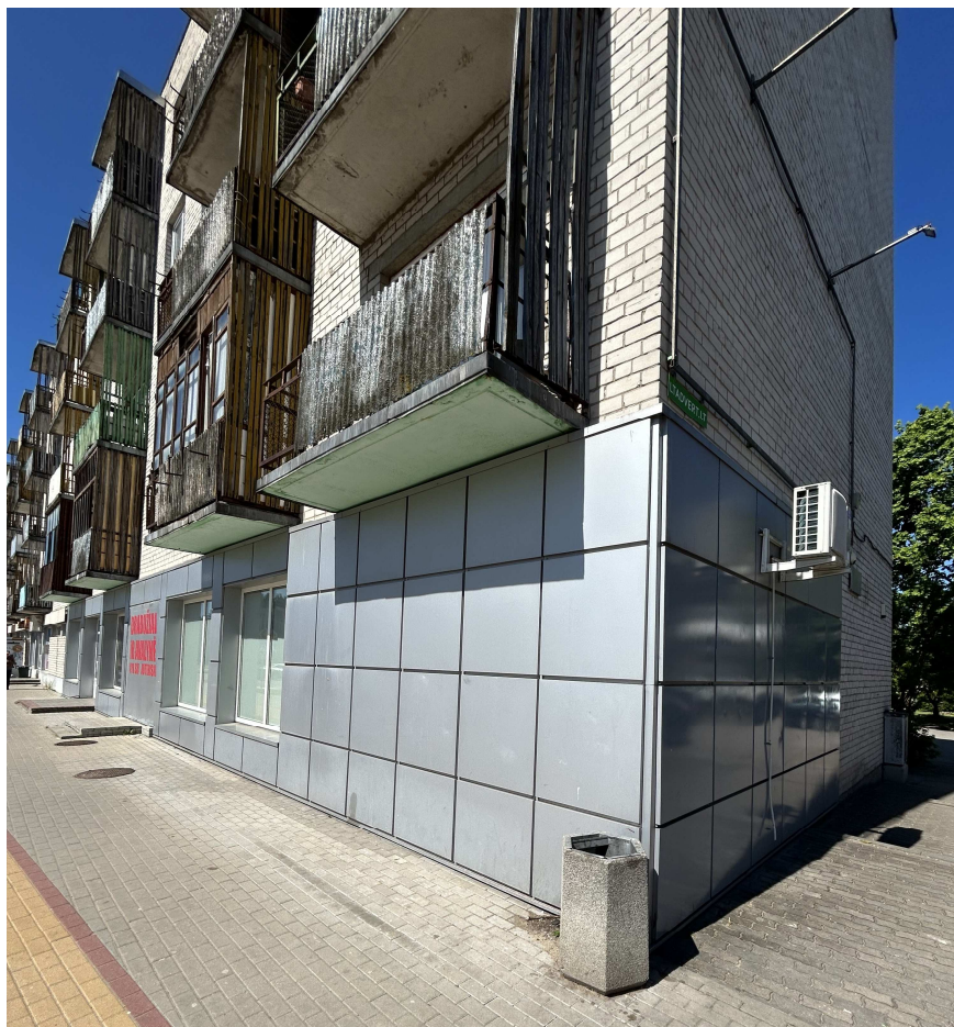
5. pav. Balkono perdangos fotofiksacija
